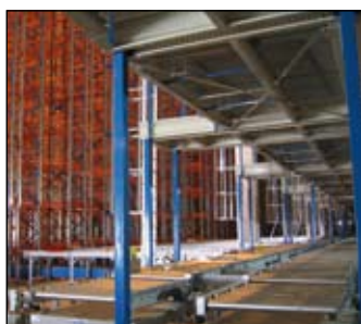
Podlažná konštrukcia na privádzacom –odvádzacom mieste AS/RS-systému
