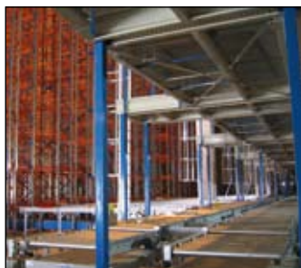
Konstrukcja podstawa przy wejściu i wyjściu systemu AS/RS.
